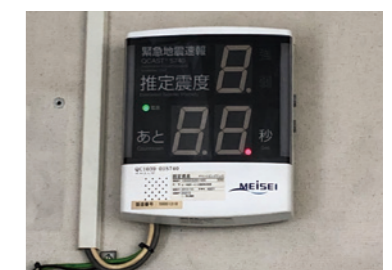
緊急地震速報受信装置(本社守衛本部)
